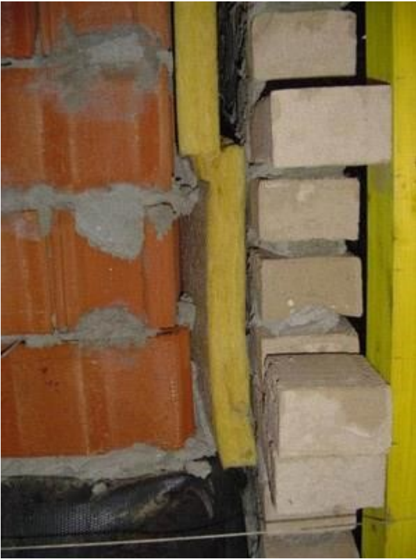
Afb. 7 Isolatiemateriaal sluit niet goed op elkaar aan
