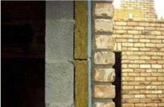
Afb. 2 Isolatiemateriaal sluit niet goed op elkaar aan (bron: Nieman)
