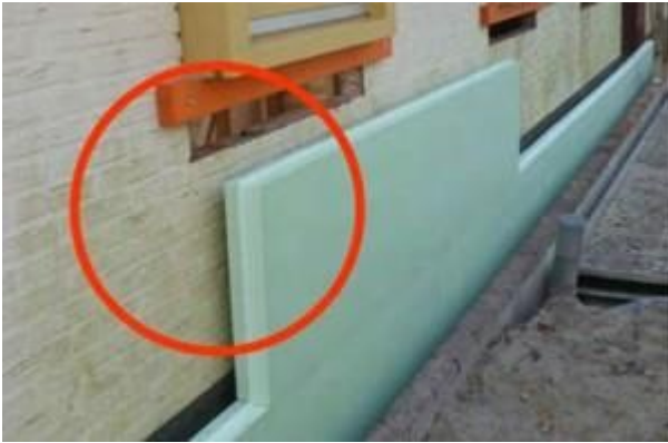
Afb. 9 Isolatiemateriaal sluit niet goed aan op het binnengevelblad (bron: Nieman)
