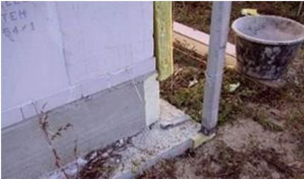
Afb. 4 Isolatiemateriaal sluit niet goed aan op omliggende constructies
