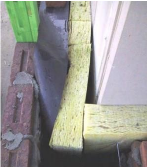
Afb. 6 Isolatiematerialen sluiten niet goed aan, hierdoor ontstaat een open hoek (bron: Nieman)
