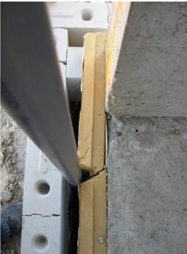
Afb. 8 Onderbreking van het isolatiemateriaal
