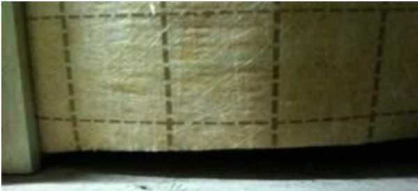
Afb.5 Isolatiemateriaal sluit niet goed aan op de vloer (bron: Nieman)
