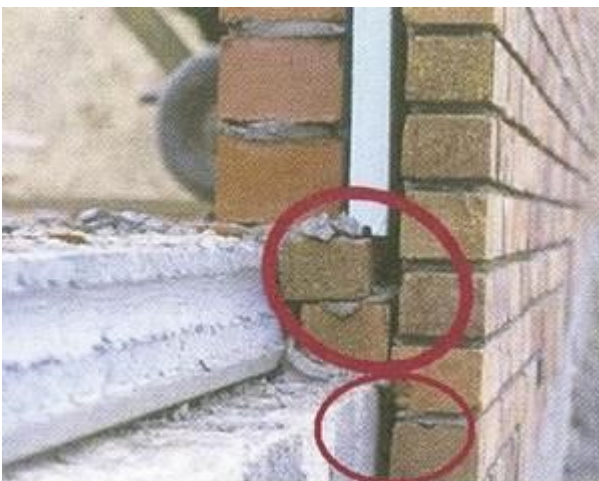
Afb. J.3 Isolatiemateriaal is niet goed doorgezet waardoor er een koudebrug ontstaat (bron: Nieman)
